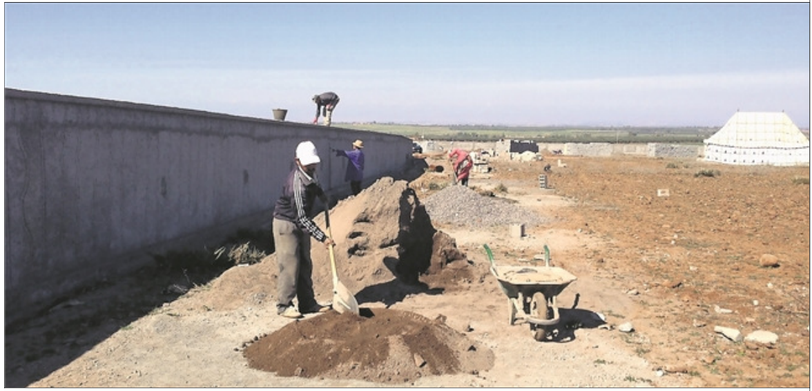
Das Kinderdorf Dar Boudiar wächst in die Höhe: Die Bauarbeiten sichern Arbeitsplätze für Einheimische. Foto: zvg.
